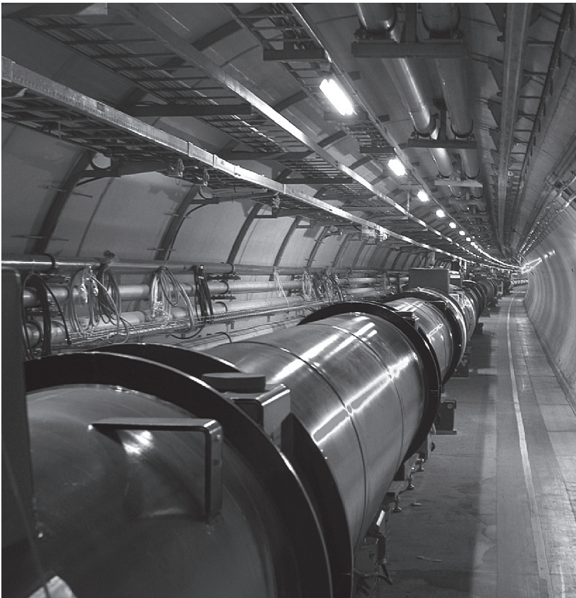
Figura 2. Tunnel di LHC con un "dipolo superconduttore" in primo piano.
